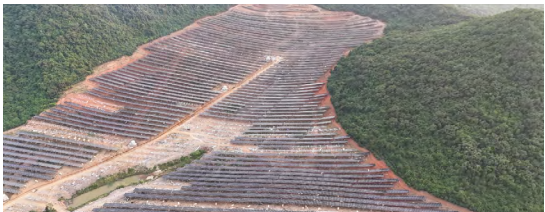
乐东县国能 100 兆瓦农光互补光伏发电一期项目光伏区
