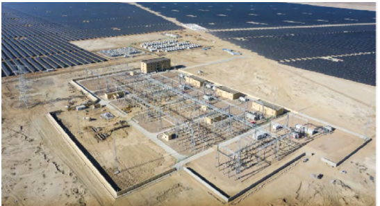
甘肃民勤独立共享储能项目全景
