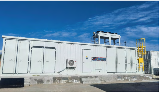
国内首套新能源电站集中式次同步振荡抑制装置
