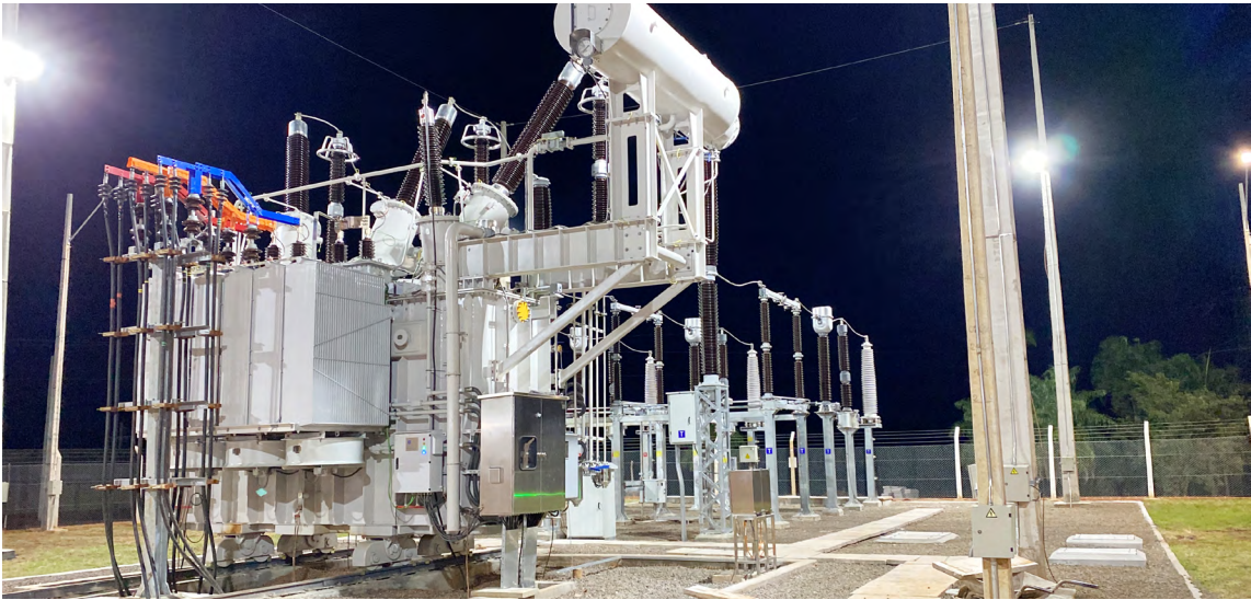
国电南瑞承接巴拉圭 220 千伏 DYN 变电站项目成功送电
