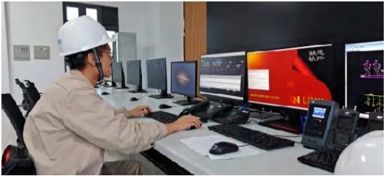
国电南瑞技术人员在山东半岛南 U 场址海上风电项目现场调试后台系统
