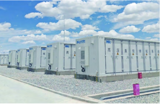
构网型高压直挂储能在青海海西州宝库储能电站满容量充放电投运成功
