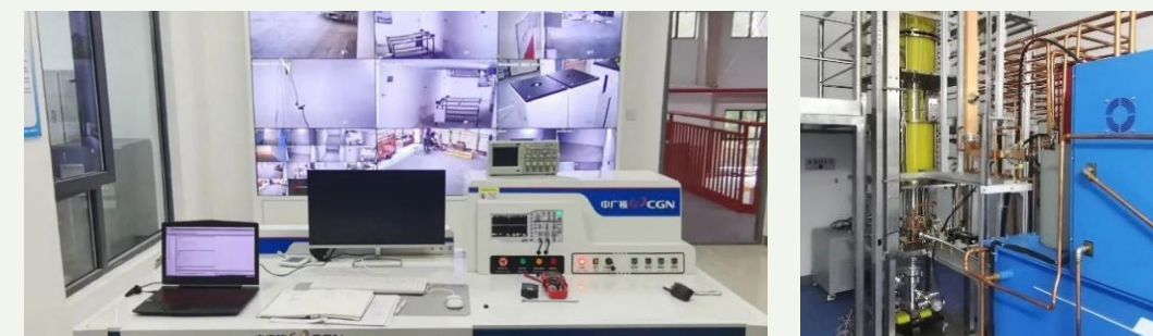
10MeV/32kW 工业辐照电子加速器控制室和主体设备
