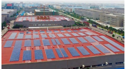
中设国联浙江宁波杭州湾方太5.03MW屋顶分布式光伏发电项目
