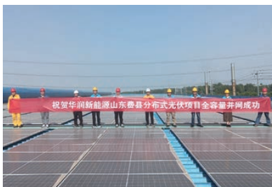
山东费县8.46MW屋顶分布式光伏项目全容量并网
