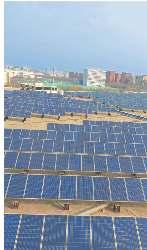
冠捷制造基地光伏设施
