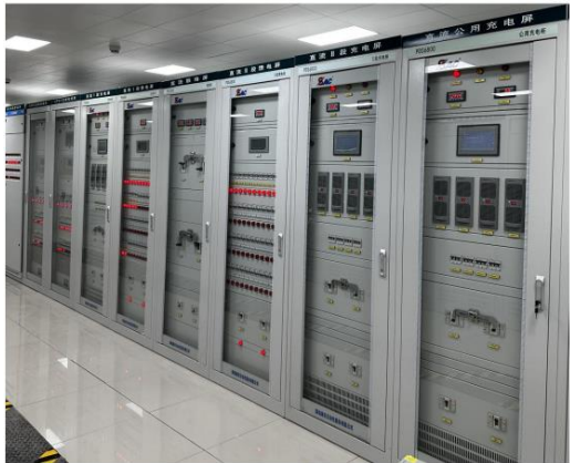
电力操作电源应用于变电站
