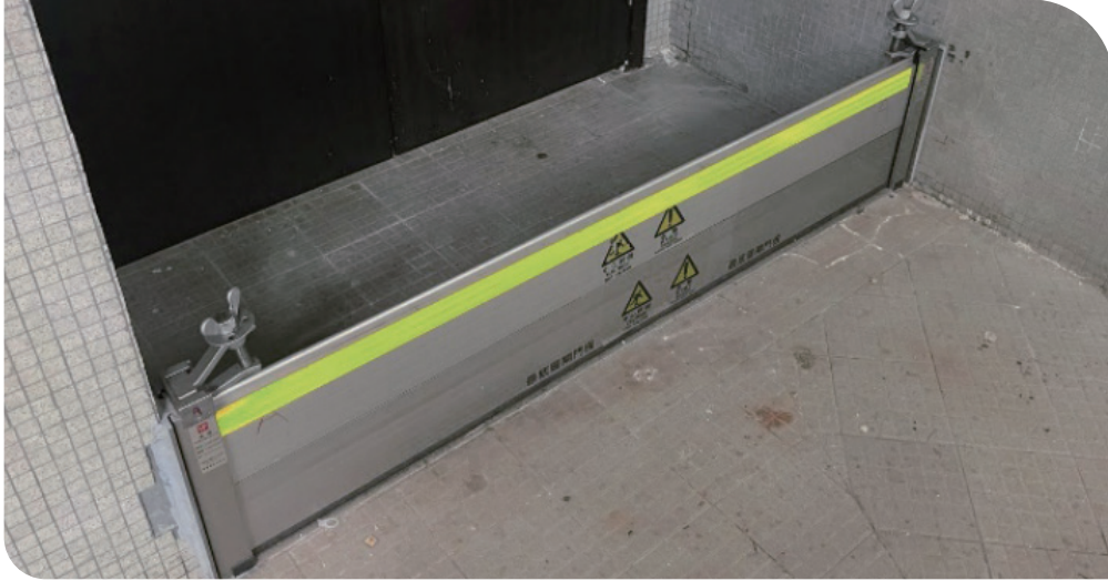
富豪機場酒店的防洪閘
