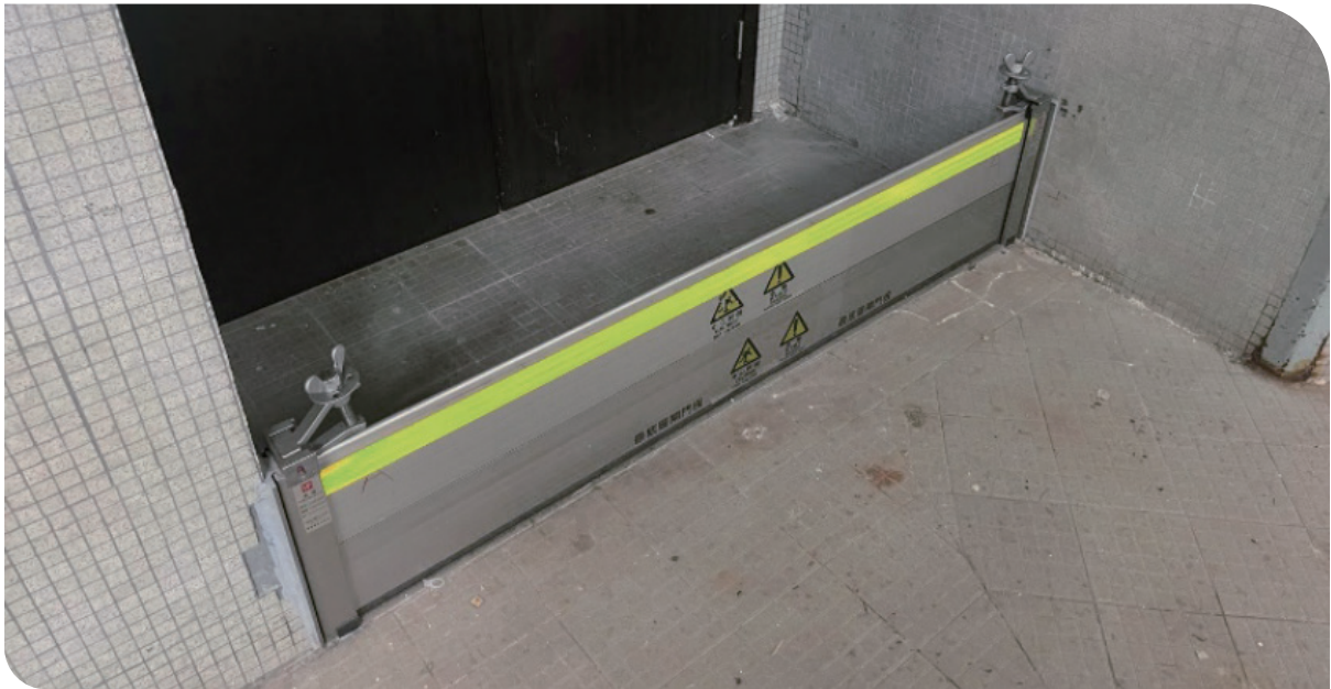
富豪機場酒店的防洪閘
