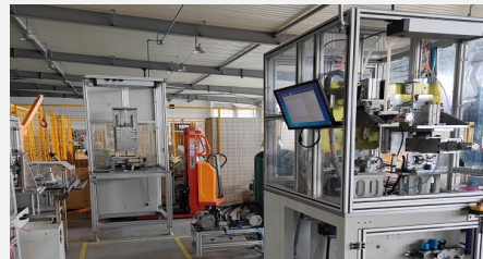
改造后的油泵气测工艺
