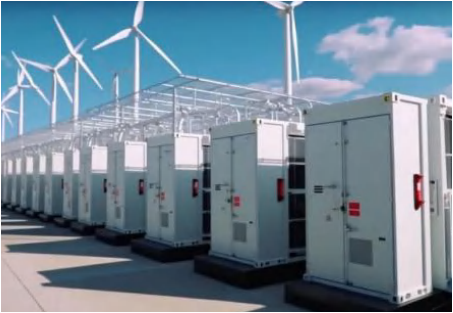
江苏丰储共享储能项目
