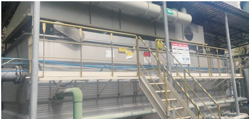
废水处理设施
