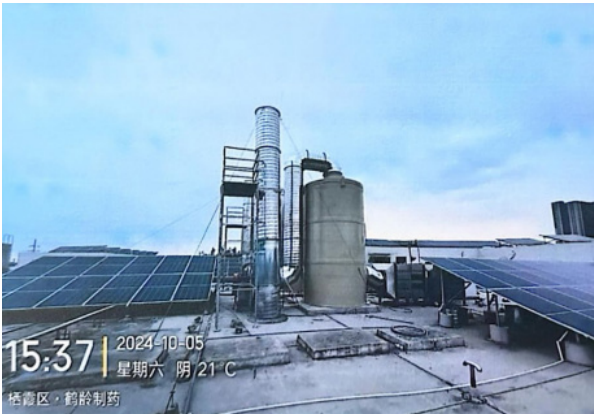
10月5日，鹤龄药事的废气设备主体升级改造项目完成，并通过南京经济技术开发区环境保护局现场验收。
