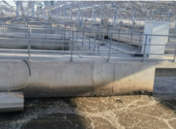
▲ 固定式温室气体在线监测现场
