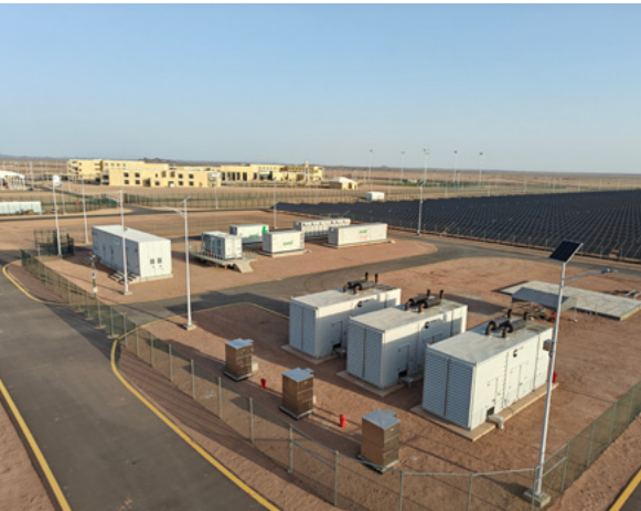
沙特阿拉伯东离网直流耦合电池储能系统，耐热防沙，能够在极端环境下将电池温度控制在 35°C 以下，温差 不超过 5°C。
