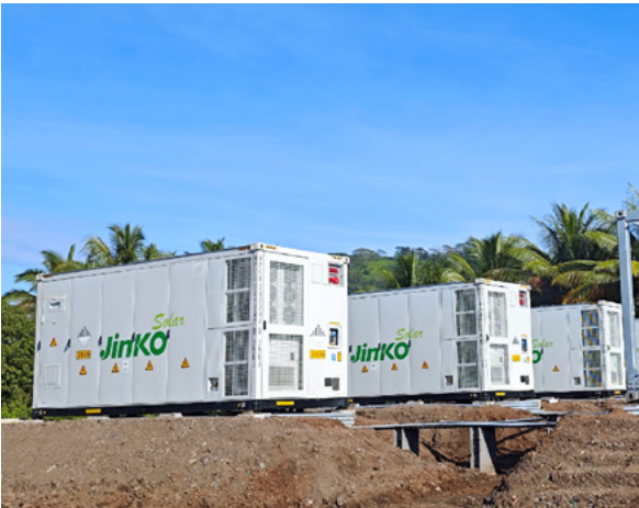
法属波利尼西亚大溪地大型光储项目搭载了蓝鲸 SunTera 储能系统，具备 C5 级耐腐蚀性能，适配大溪地近海环境条件和气候，确保了系统的长期稳定性和高度耐用性。
