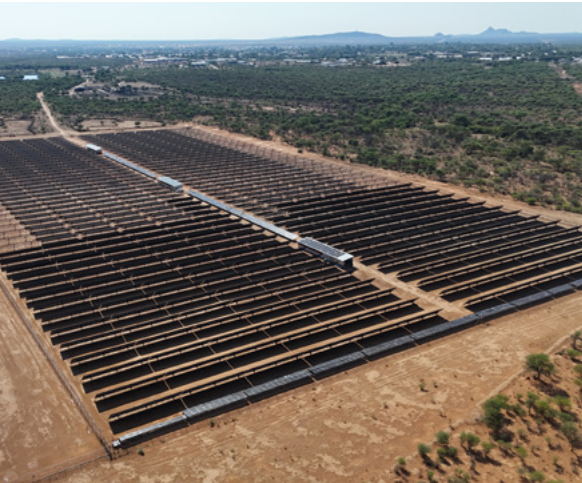
纳米比亚 Otjiwarongo PV Park Extension 项目
