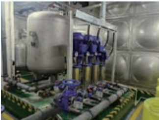
園林綠化儲水箱及水泵
