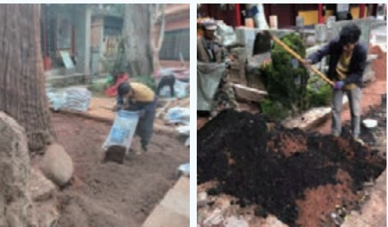
土壤改良示例
