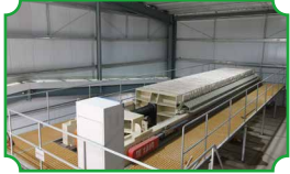
板框压滤处理配套设备
