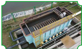
纤维过滤器(进水区)
