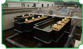
纤维过滤器(尾水区)
