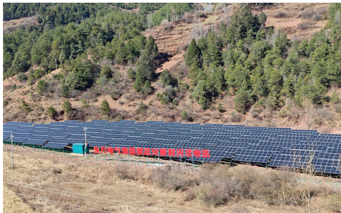
火普村光伏電站
