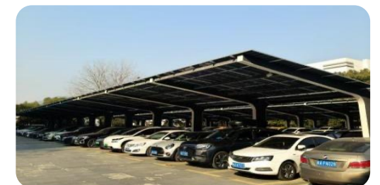
園區光伏發電組件
