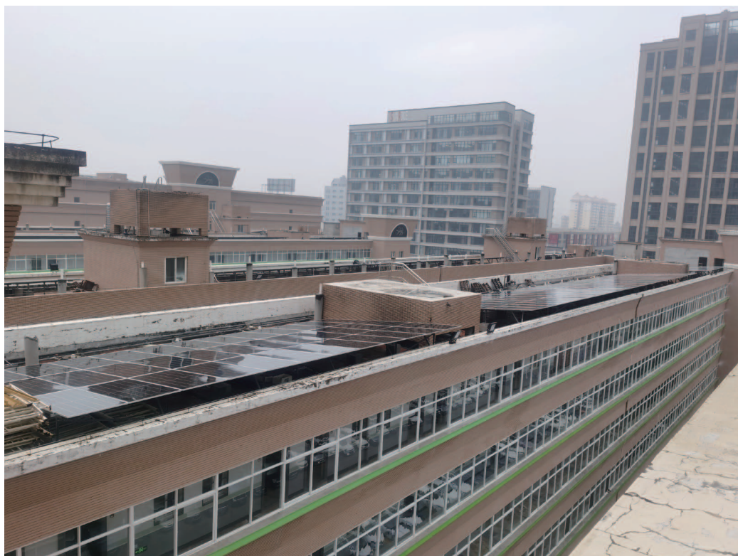
光伏發電設備
