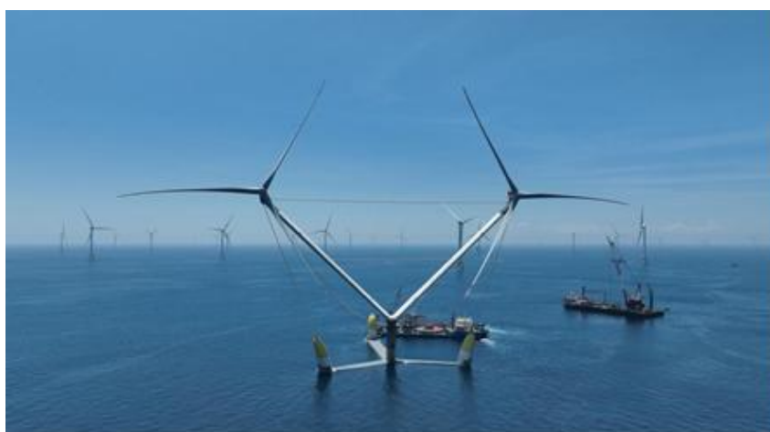
图：明阳智慧能源集团“明阳天成号”16.6MW漂浮式海上风电示范项目35kV动态海底电缆工程
