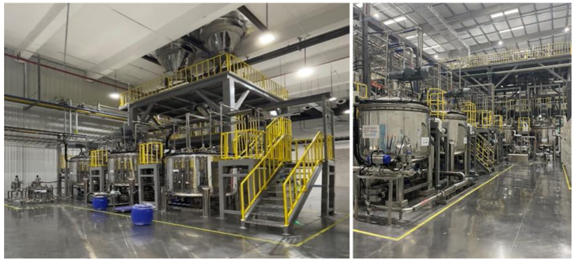
循环式高效制浆系统实景图
