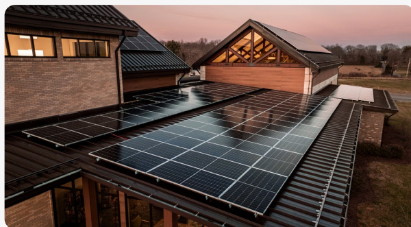
① 美国肯塔基州社区公共图书馆光伏项目
