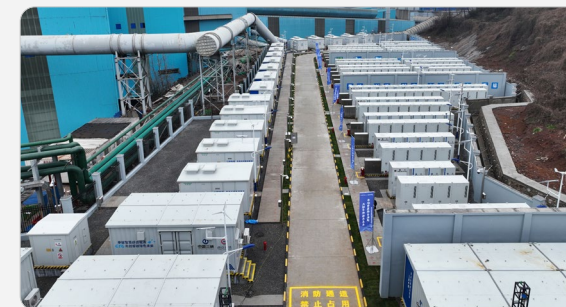
① 南京南钢 61MW/123MWh 储能电站项目
