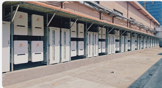
① 绍兴昱曙 900kw/1843.2kwh 储能项目
