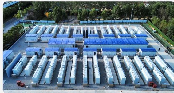
① 梅钢 50MW/100MWh 储能项目
