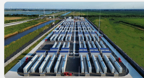
① 江苏滨海 200MW/400MWh 储能电站
