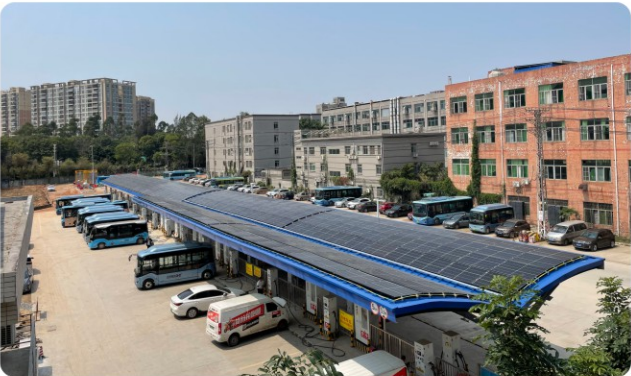
(万江官桥滘“光储充”一体化电站)
