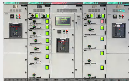
智能中低压开关柜
