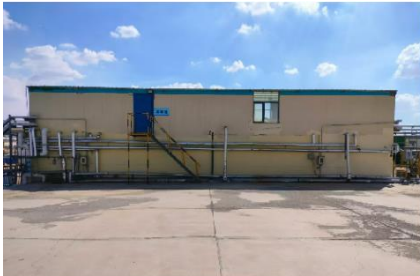
废水生化处理系统
