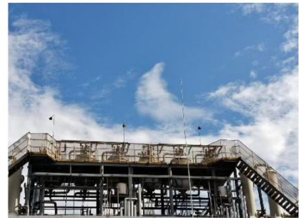
活性炭和碱液废气吸收系统
