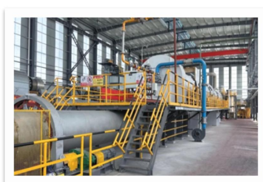
图：金安矿业永磁铁氧体预烧料项目生产线
