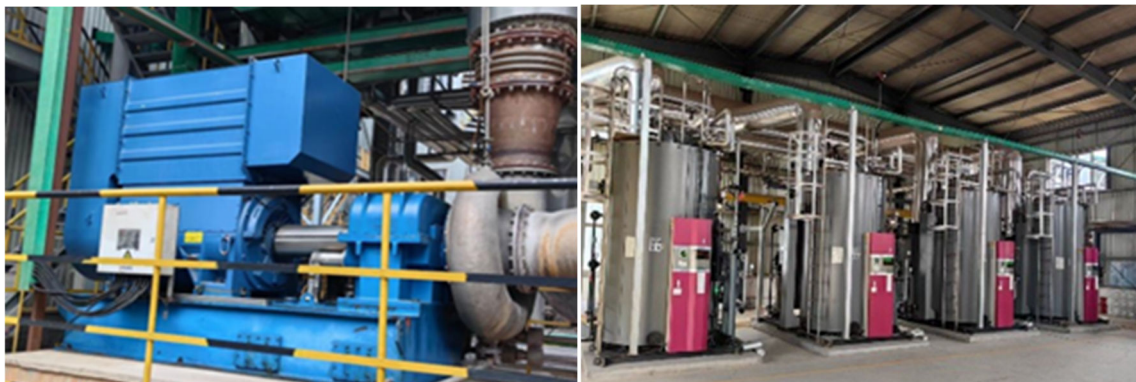
江西生产基地使用高效锅炉、空压机
