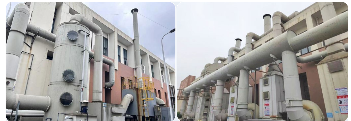
废气处理装置
