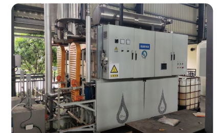
废液蒸发浓缩设备
