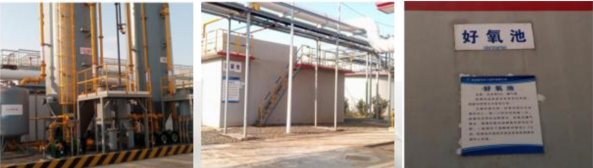
废水处理设施
