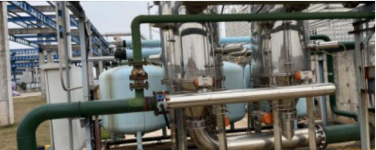
江西仰立冷却循环水系统
