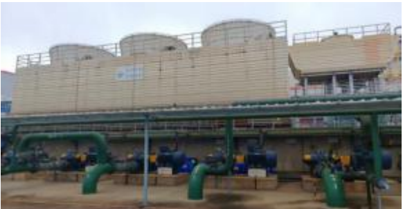
江西天宇冷却循环凉水塔
