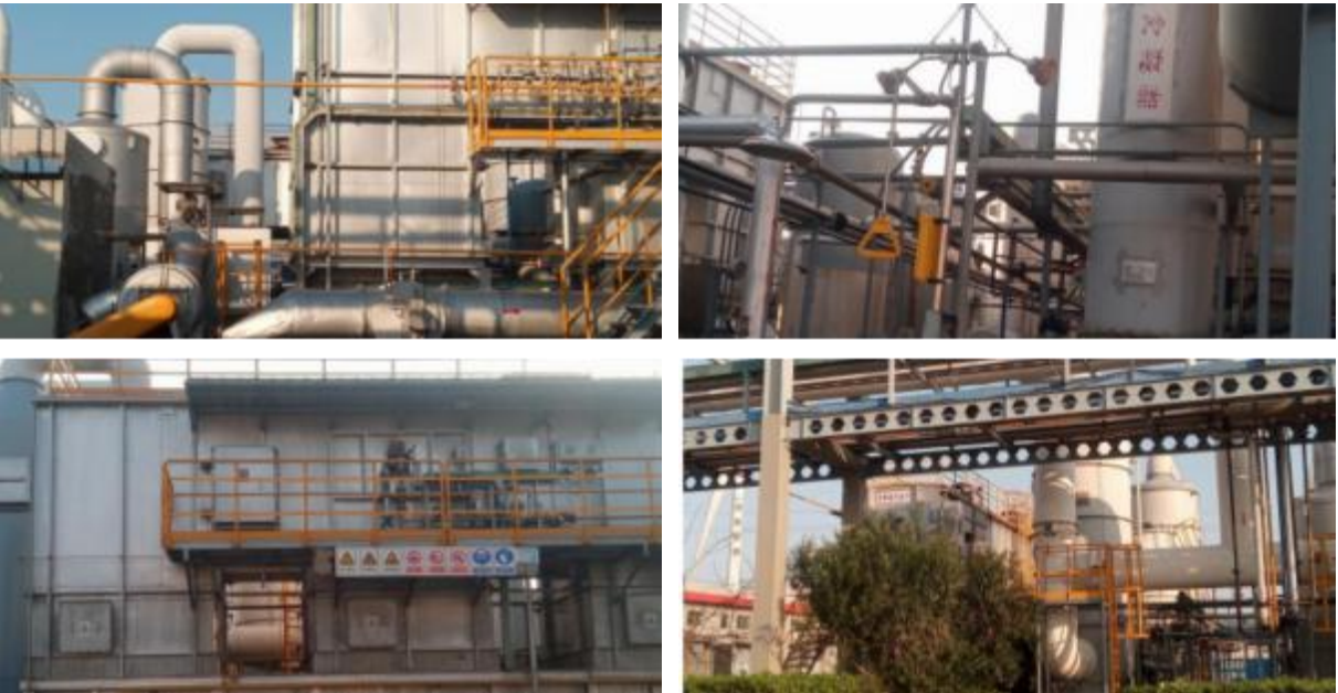
废气处理设施
