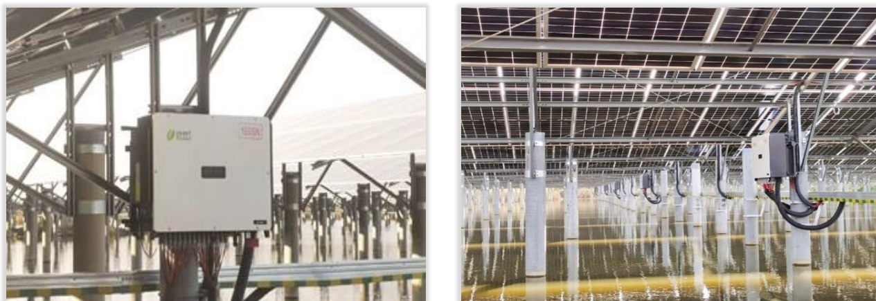
图 3：泰州 100MW 渔光互补+10MW/20MWh 储能项目
