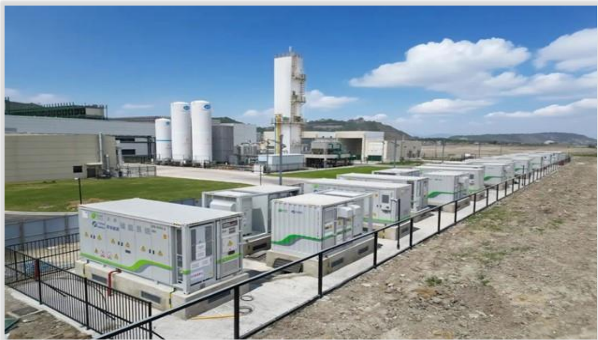
图 2：浙江乐清 30MW/60MWh 储能项目
