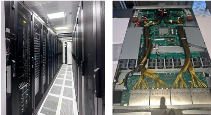
图：某互联网中卫数据中心项目
