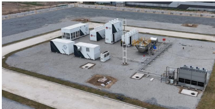
图：盐城大丰港光氢储综合能源项目
