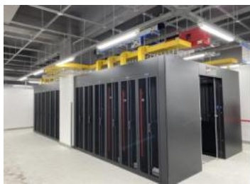
数据中心及微模块数据中心
