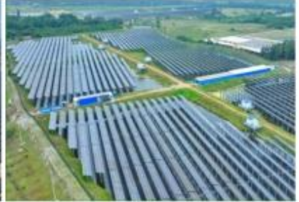
中广核文昌翁田 100MW 农渔光互补光伏发电项目
