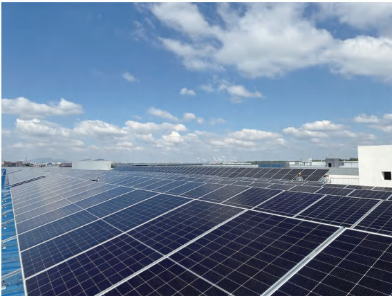
E区新建1.56MW光伏
