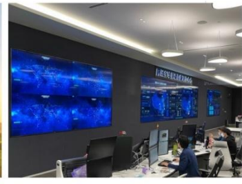
腾讯数据中心弹性高压直流项目
