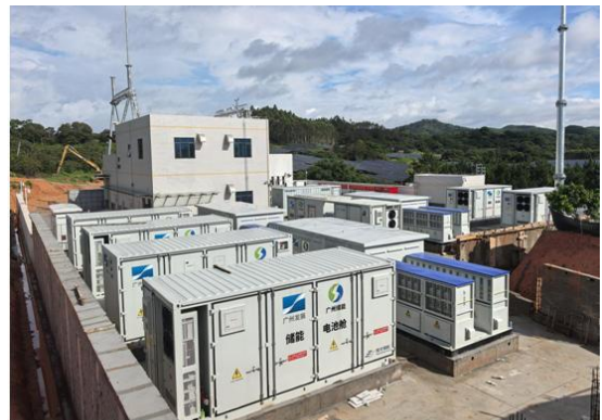
图:惠东梁化新能源配储项目
