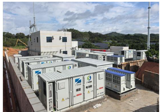
图：惠东梁化新能源配储项目。
