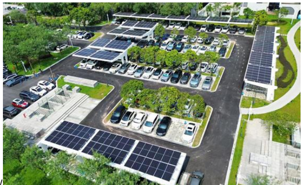
图：广州天河体育中心东南角光伏车棚。
