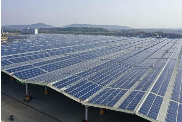
发行人江西丰城生产基地光伏厂房
