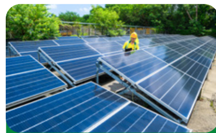
位於西沙建築工地的太陽能發電場
