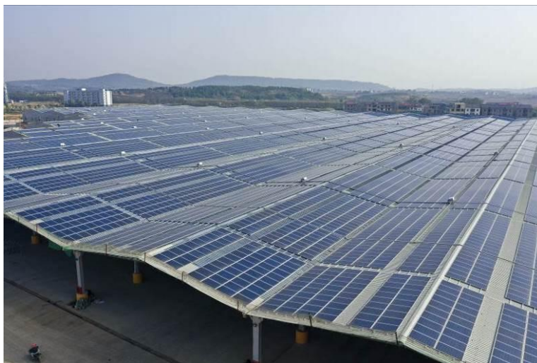
发行人江西丰城生产基地光伏厂房
