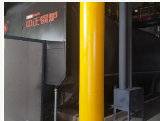
文艺热源厂燃气锅炉
