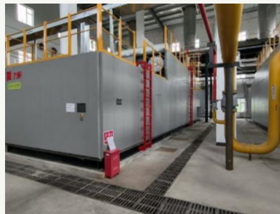
棋盘山热源厂燃气锅炉
