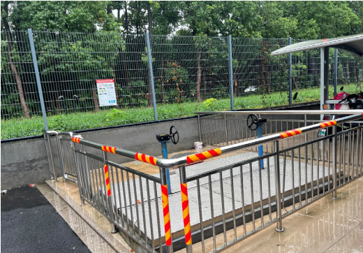
雨水池、消防水池照片
