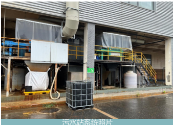
污水站系统照片
