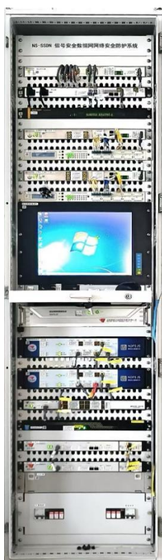
NS-SSDN 信号安全数据网（列控系统）网络安全防护系统机柜
