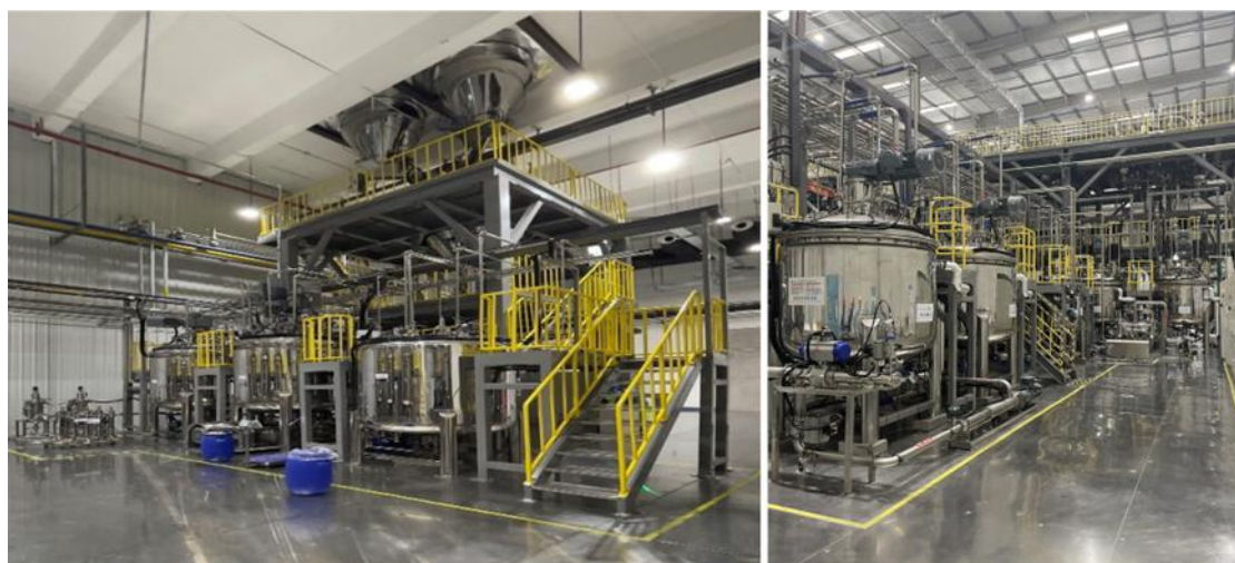
循环式高效制浆系统实景图
