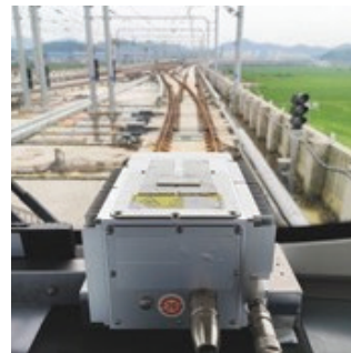
安裝在列車上 (內部視角)
