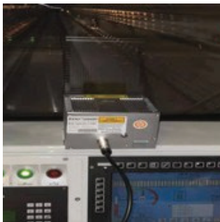
安裝在地鐵列車上
