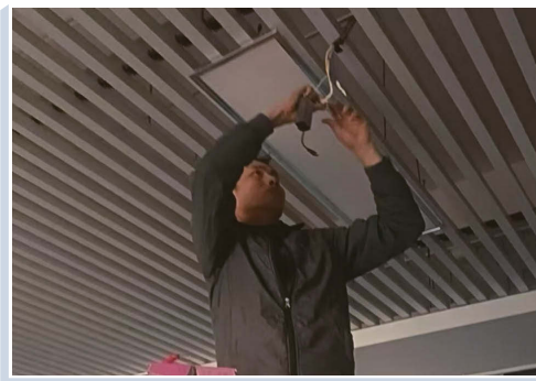
教學樓、宿舍樓走廊升級節能感應燈
