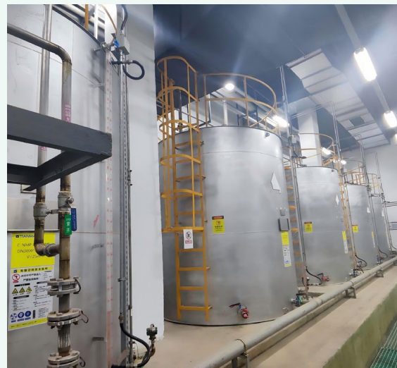
NMP 废液回收再利用项目
