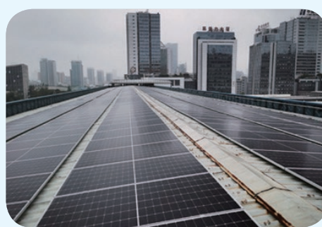
药友制药光伏设施
