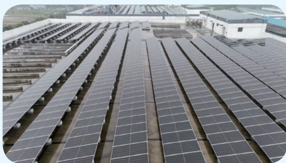
淮阴医疗光伏设施
