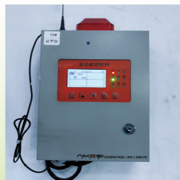
VOCs监控系统
