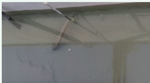
原水池吸泥泵
