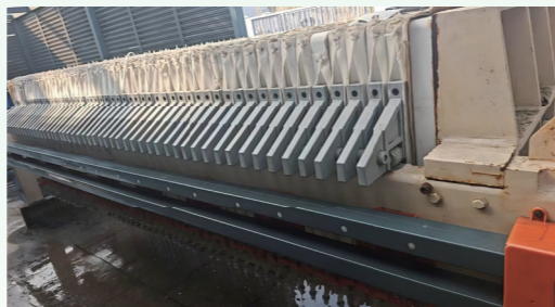
污泥压滤装置
